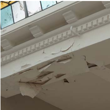
Des traces évidentes d'infiltrations...
