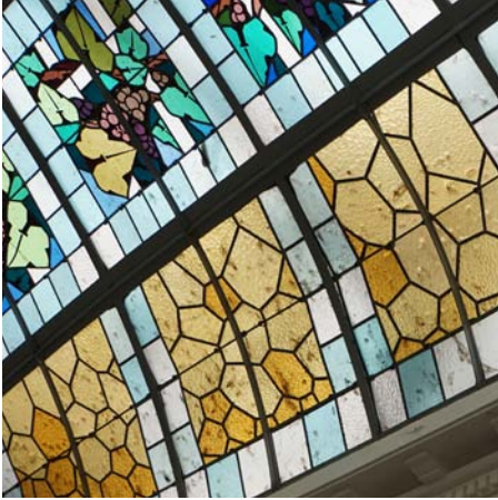
Beaucoup de corps étrangers font leur apparition malgré la toiture de protection.
